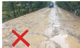
坑洼、颠簸路面
